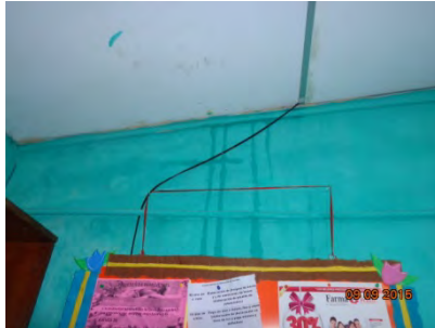
Wasserspuren an den Bürowänden Foto: © MIRIAM
