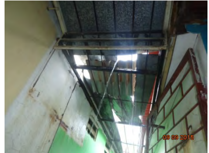
Regen läuft direkt durch das Dach Foto: © MIRIAM
